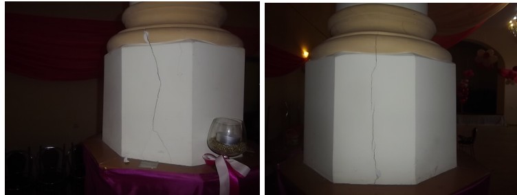
fot. nr 16 i 17 Pęknięcia na zabudowie słupów
