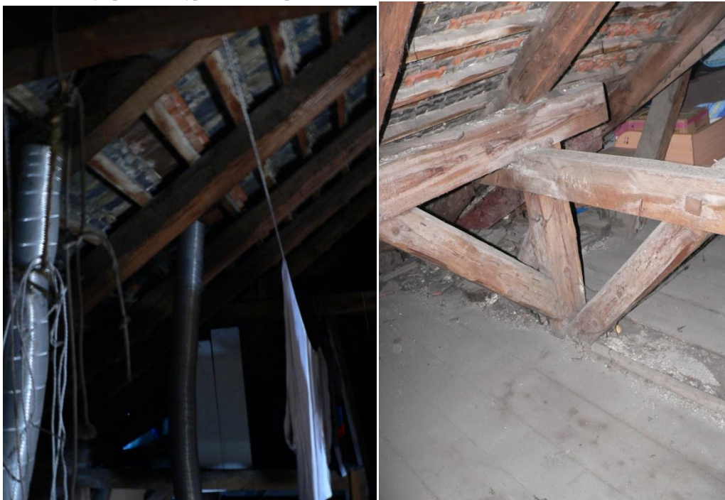
Fot. 79 Kanały spiro bez wyprowadzenia ponad dach Fot. 80 Wieżba dachowa
