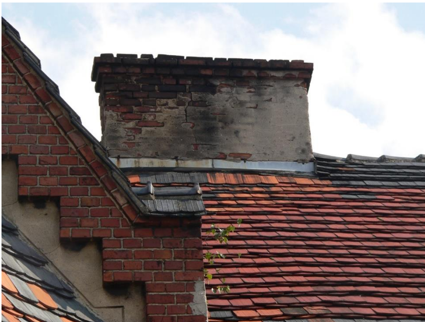
Fot. 27 Komin uszkodzenia
