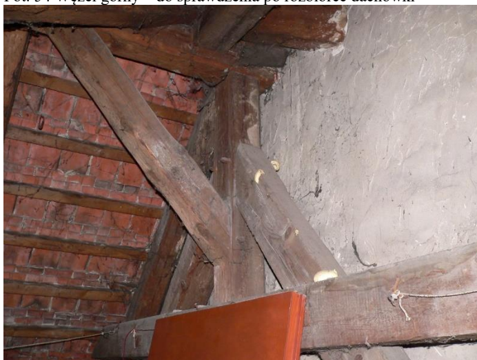
Fot. 54 Węzeł górny – do sprawdzenia po rozbiórce dachówki
