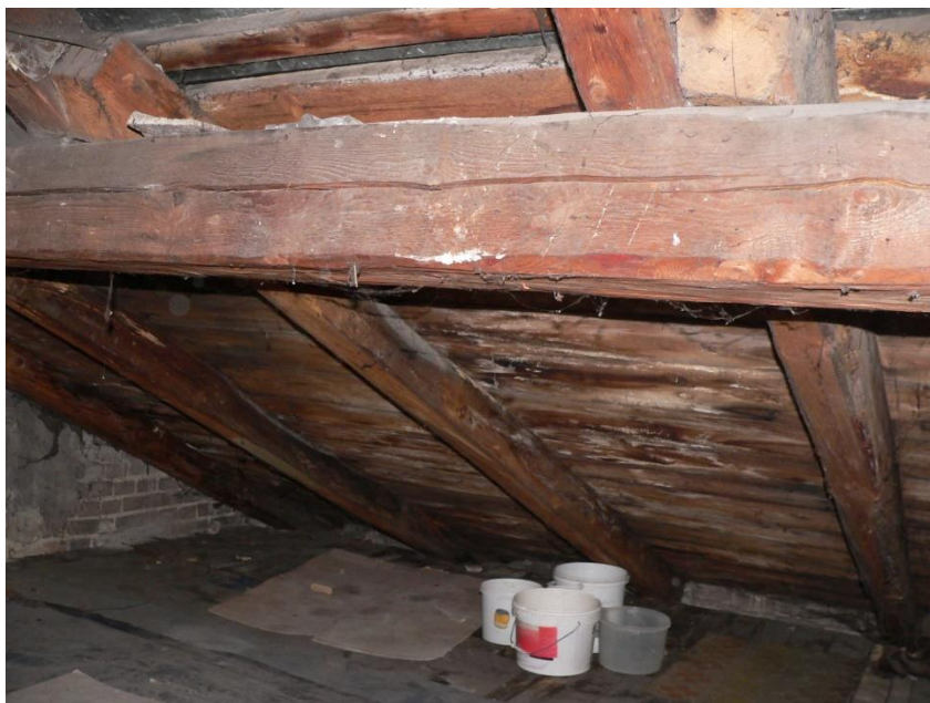
Fot. 64 Widoczne zacieki na deskach i krokwiach
