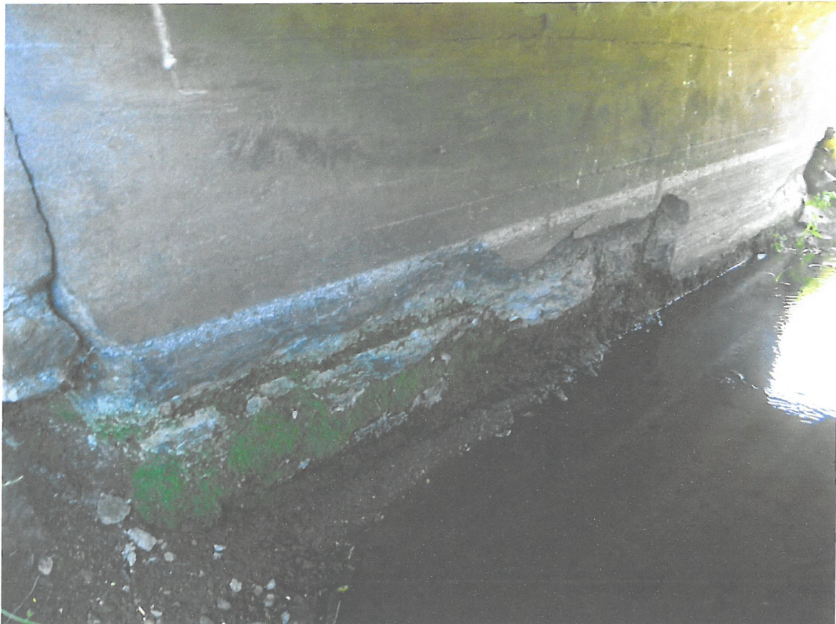
Rys. 6. Lewobrzeżna, fundamentowa część przepustu. Głębokie wżery korozyjne na poziomie zmiennych wód w betonie konstrukcji ramy.
