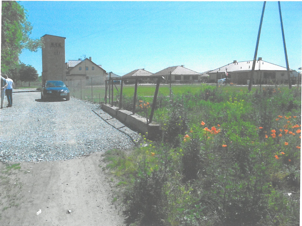
Rys. 3. Droga na przepuście w trakcie remontu. Widoczne braki w wypełnieniu oporęczowania.
