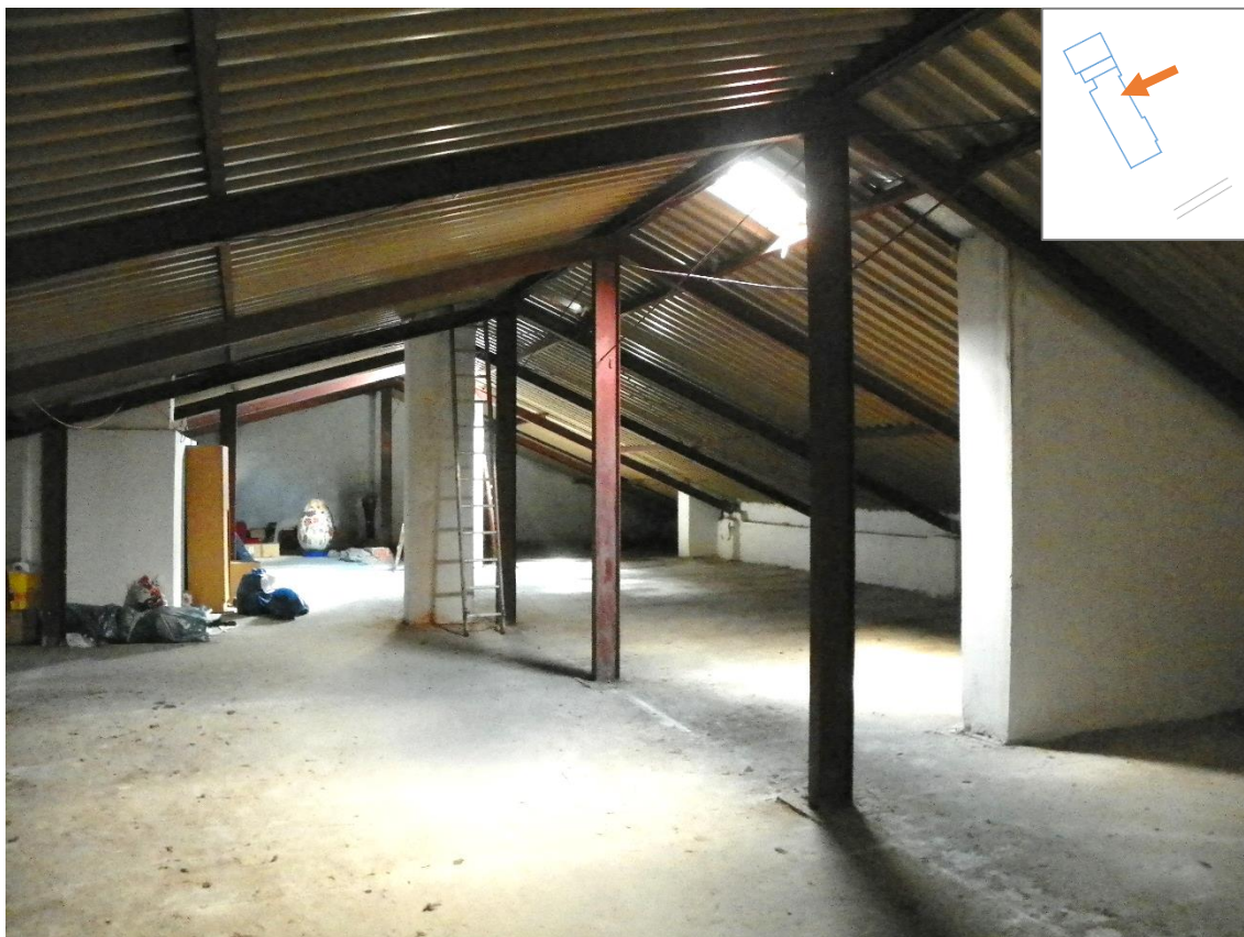
Fot. 11. Strych części A budynku Zespołu Szkół w Chrzęstawie Wielkiej (stan na dzień 06-06-2016 r.).
