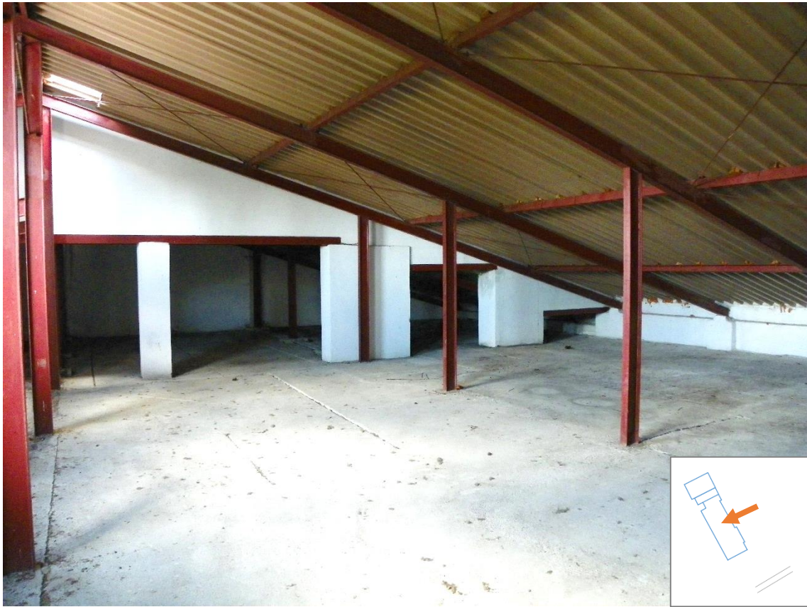
Fot. 9. Strych części A budynku Zespołu Szkół w Chrzęstawie Wielkiej (stan na dzień 06-06-2016 r.).
