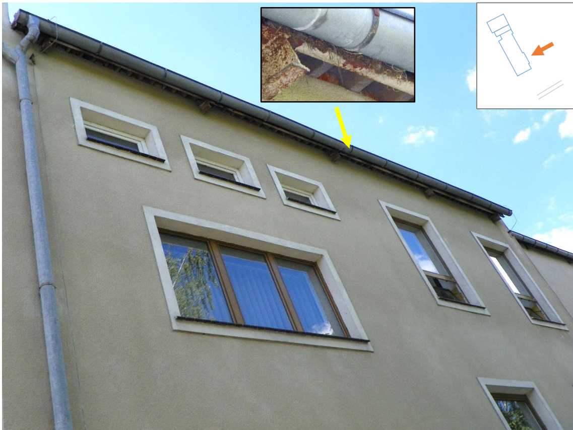
Fot. 5. Ściana A1 budynku Zespołu Szkół w Chrzęstawie Wielkiej. Żółtą strzałką zaznaczono lokalizację gniazda wróbla (stan na dzień 06-06-2016 r.).
