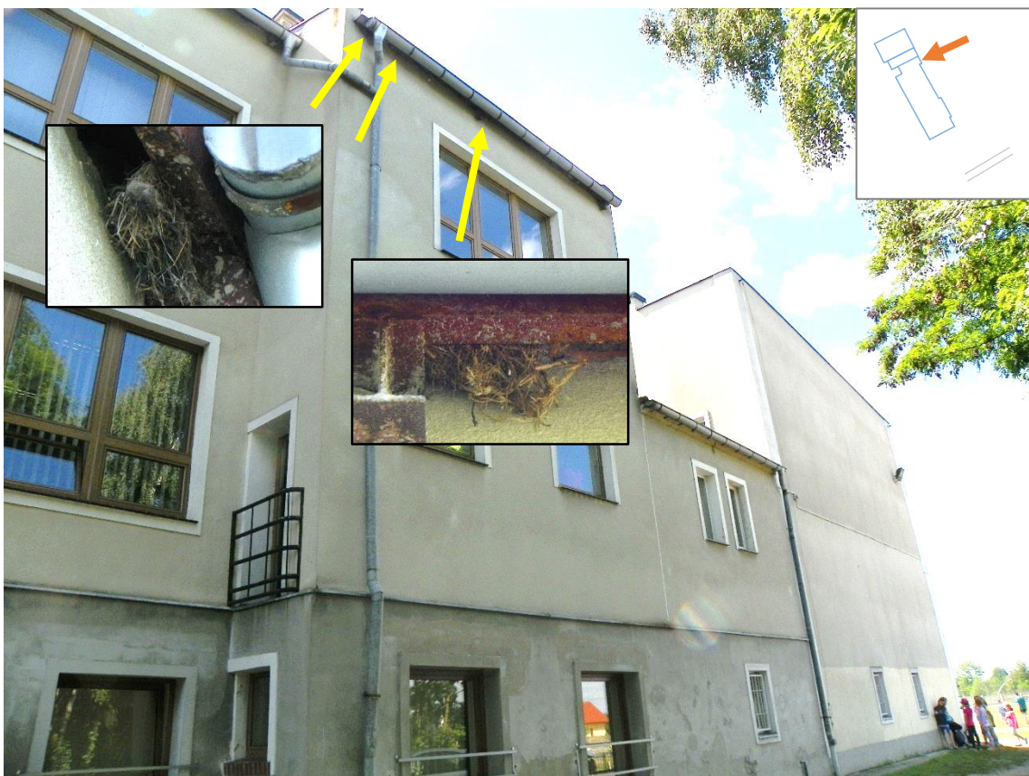
Fot. 6. Ściana A1 budynku Zespołu Szkół w Chrzęstawie Wielkiej. Żółtymi strzałkami zaznaczono lokalizację gniazd wróbla (stan na dzień 06-06-2016 r.).
