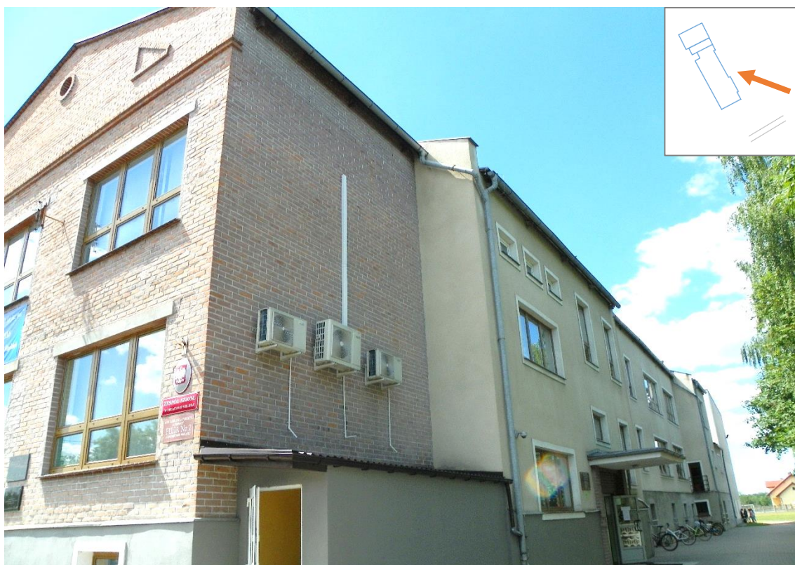
Fot. 2. Ściana A1, B1, C1 budynku Zespołu Szkół w Chrzęstawie Wielkiej (stan na dzień 06-06-2016 r.).
