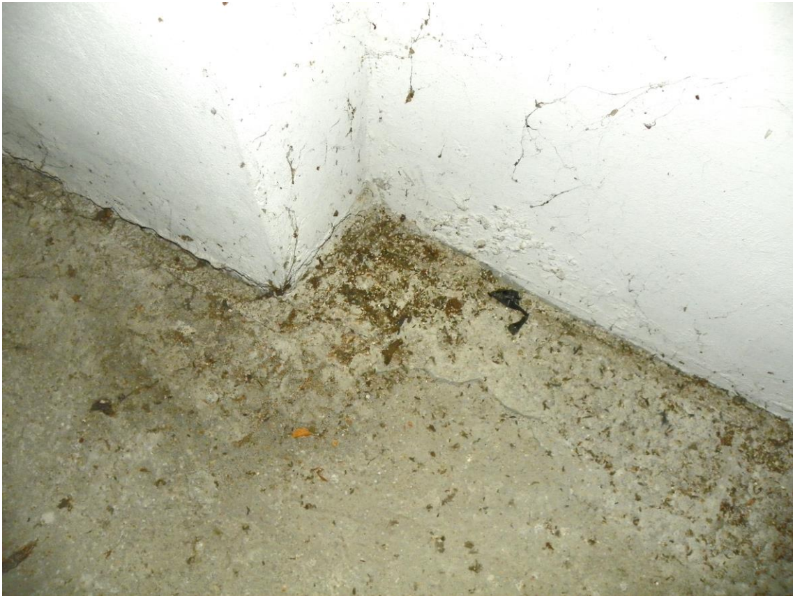
Fot. 13. Ślady wykorzystywania strychu części A budynku Zespołu Szkół w Chrząstawie Wielkiej przez nietoperze (stan na dzień 06-06-2016 r.).
