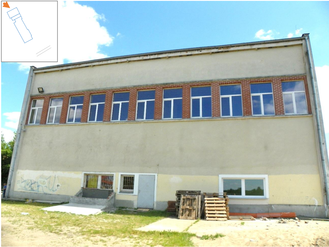
Fot. 3. Ściana C3 budynku Zespołu Szkół w Chrząstawie Wielkiej (stan na dzień 06-06-2016 r.).
