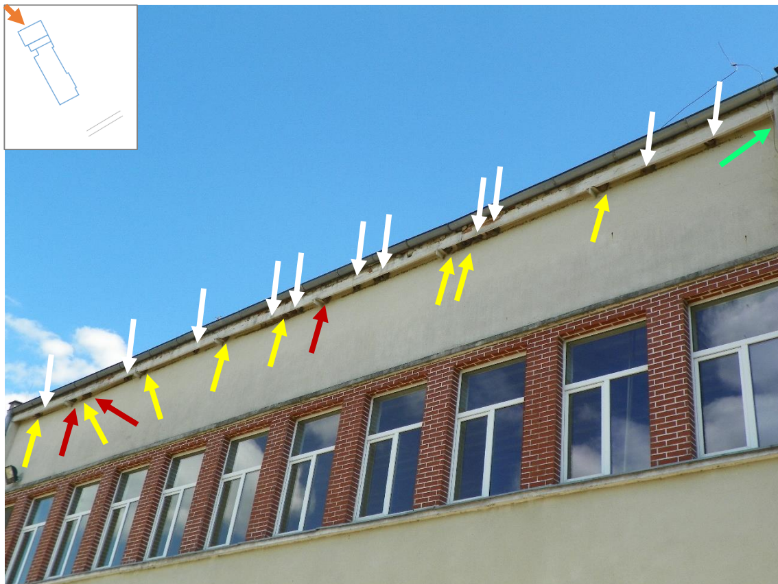
Fot. 7. Ściana C3 budynku Zespołu Szkół w Chrząstawie Wielkiej. Żółtymi i czerwonymi strzałkami zaznaczono gniazda oknówek, białymi pozostałości po starych gniazdach oknówki. Gniazda zaznaczone żółtymi strzałkami wykorzystywane są przez oknówkę, gniazda zaznaczone czerwonymi strzałkami zajęte przez wróble. Zieloną strzałką zaznaczono lokalizację szczeliny wykorzystywanej przez jerzyki. (stan na dzień 06-06-2016 r.).
