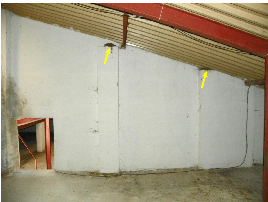
Fot. 12. Strych części A budynku Zespołu Szkół w Chrzęstawie Wielkiej. Żółtymi strzałkami zaznaczono gniazda kopciuszka (stan na dzień 06-06-2016 r.).
