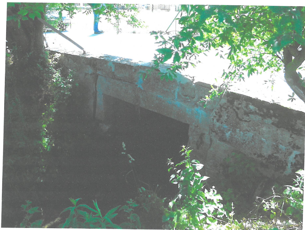
Rys.2. Wlot przepustu od dolnej wody. Widoczna korozja betonu belki krawężnikowej i ubytki betonu.
