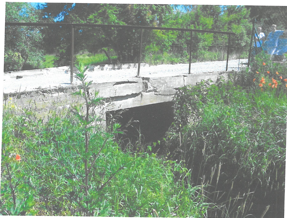
Rys. 1. Wlot przepustu od górnej wody Widoczne ubytki i spękania belki podporęczowej. Brak wypełnienia oporęczowania
