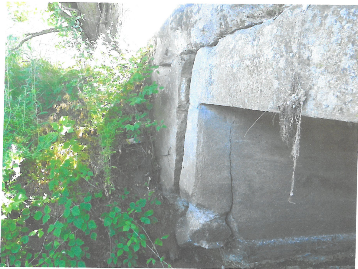
Rys. 5. Wlot przepustu od górnej wody. Ubytki i spękania betonu w części wlotowej.
