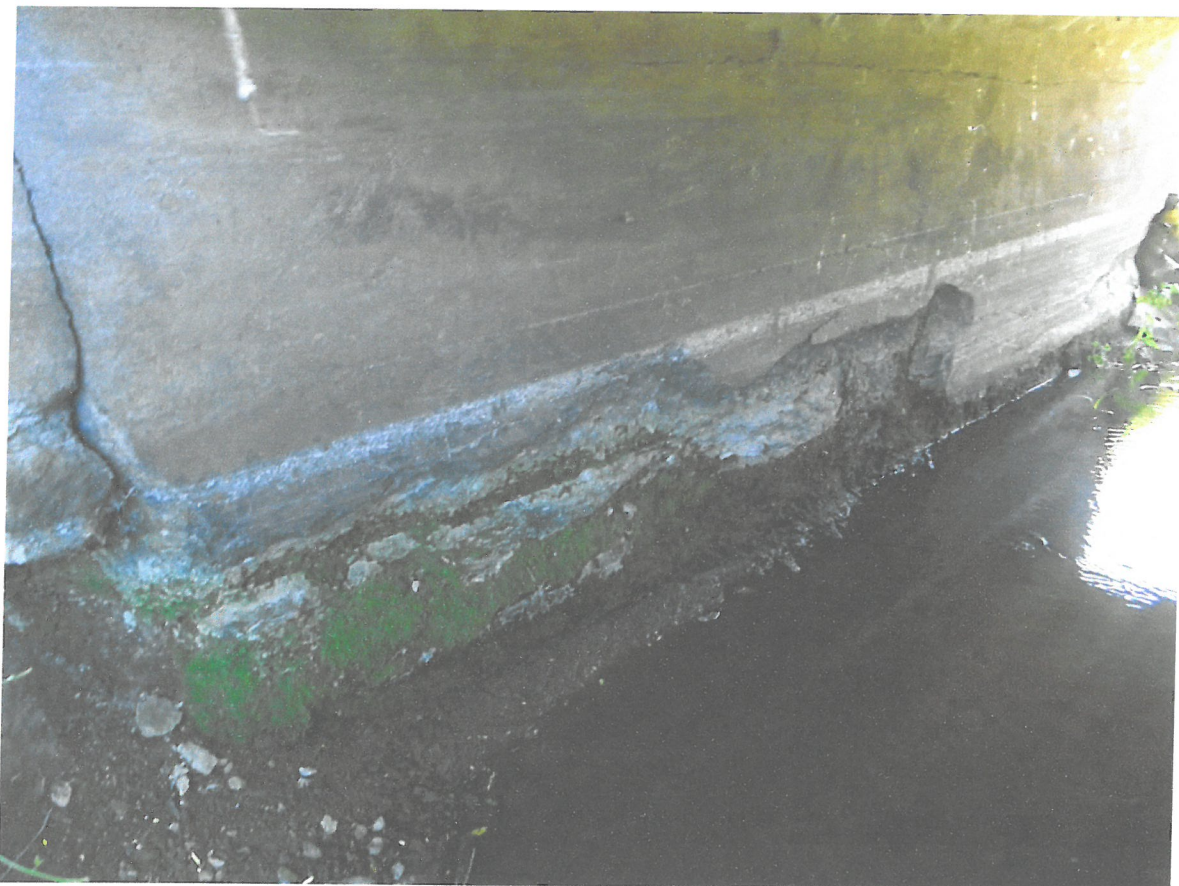
Rys. 6. Lewobrzeżna, fundamentowa część przepustu. Głębokie wżery korozyjne na poziomie zmiennych wód w betonie konstrukcji ramy.
